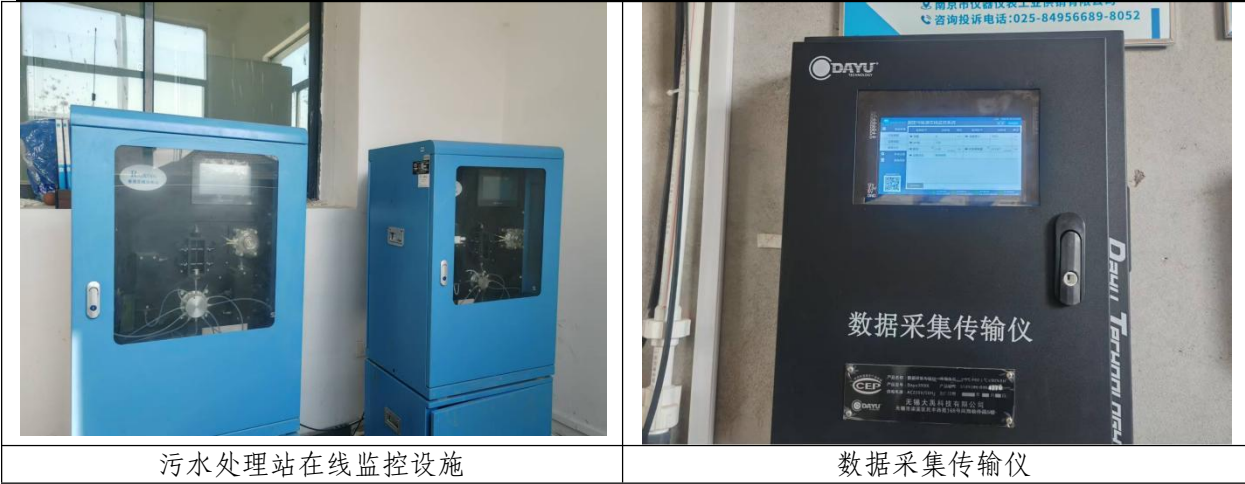
图4.1-4 污水处理站在线监测设施
