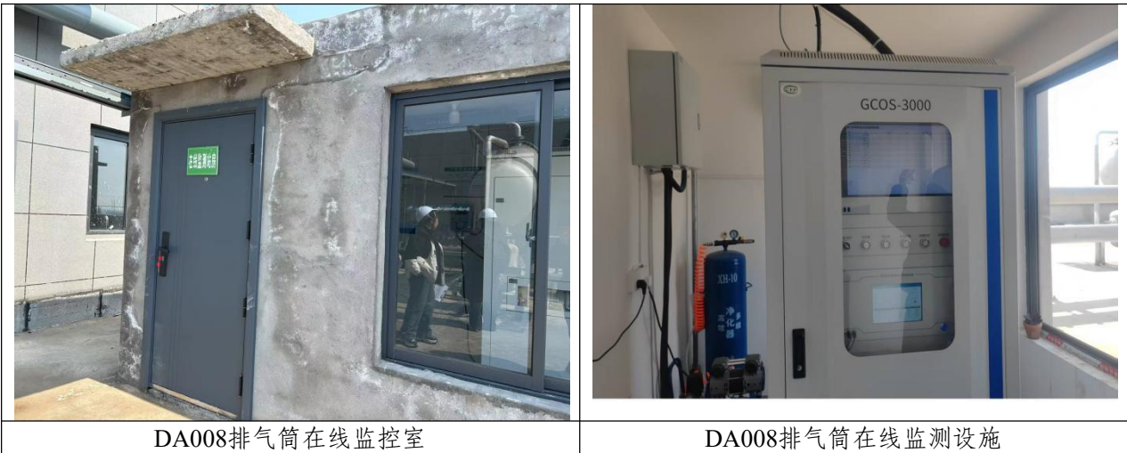
图4.1-7 DA008排气筒在线监控措施
