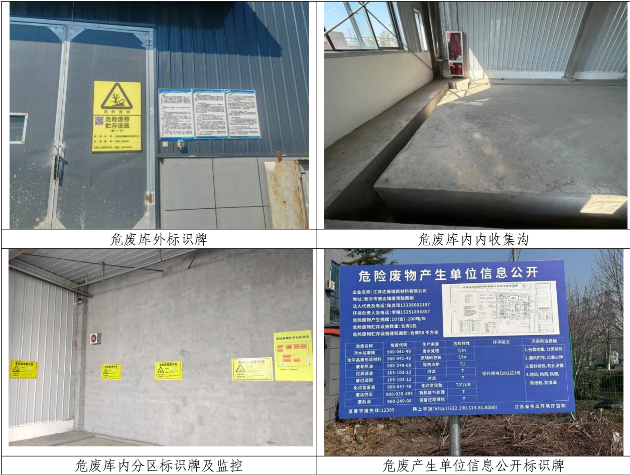
图4.1-16 危废库设置情况及相关标识牌
