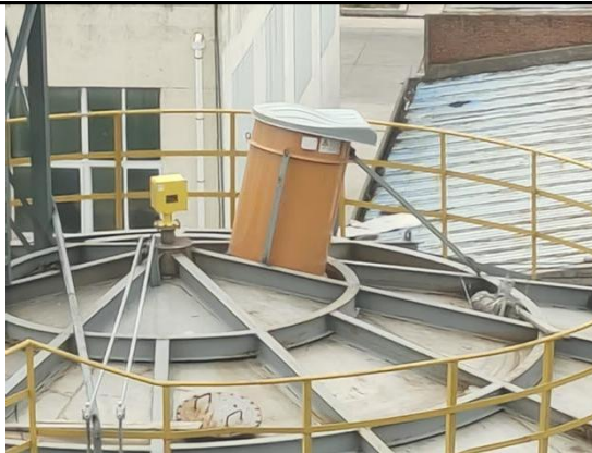
PTA储罐罐顶布袋除尘器
