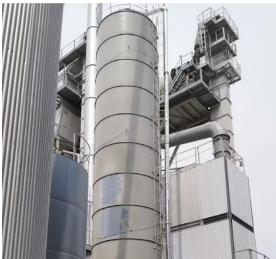
图 3-5 矿粉筒仓废气收集装置
