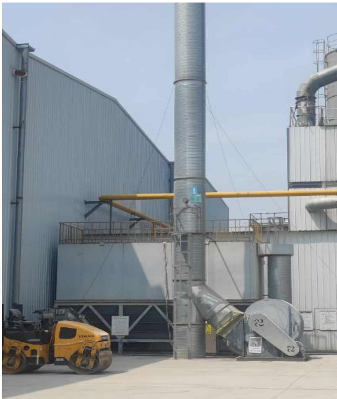
图 3-6 投料口废气及筒仓废气脉冲布袋除尘系统
