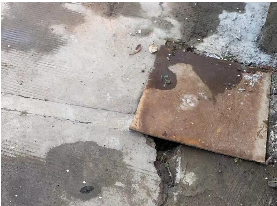
图3-1化粪池设施照片
